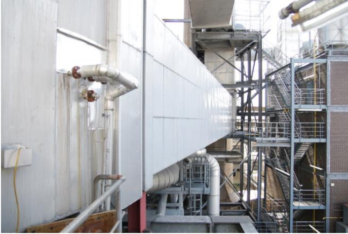
Der Rauchgaskanal von außen
