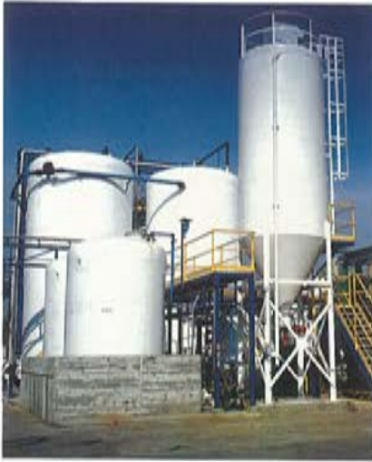
Die neue Abwasserbehandlung in Barcelona hat die CSB-Fracht gesenkt.
