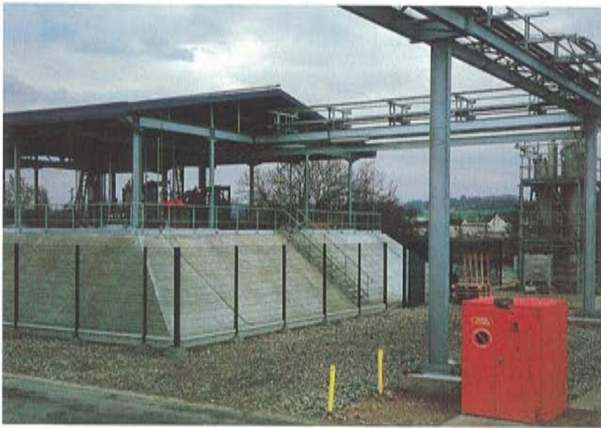
Das neue Ethylenoxid-Tanklager der Sidobre-Sinnova in Meaux ist mit aufwendigen Sicherheitsvorkehrungen ausgestattet.
