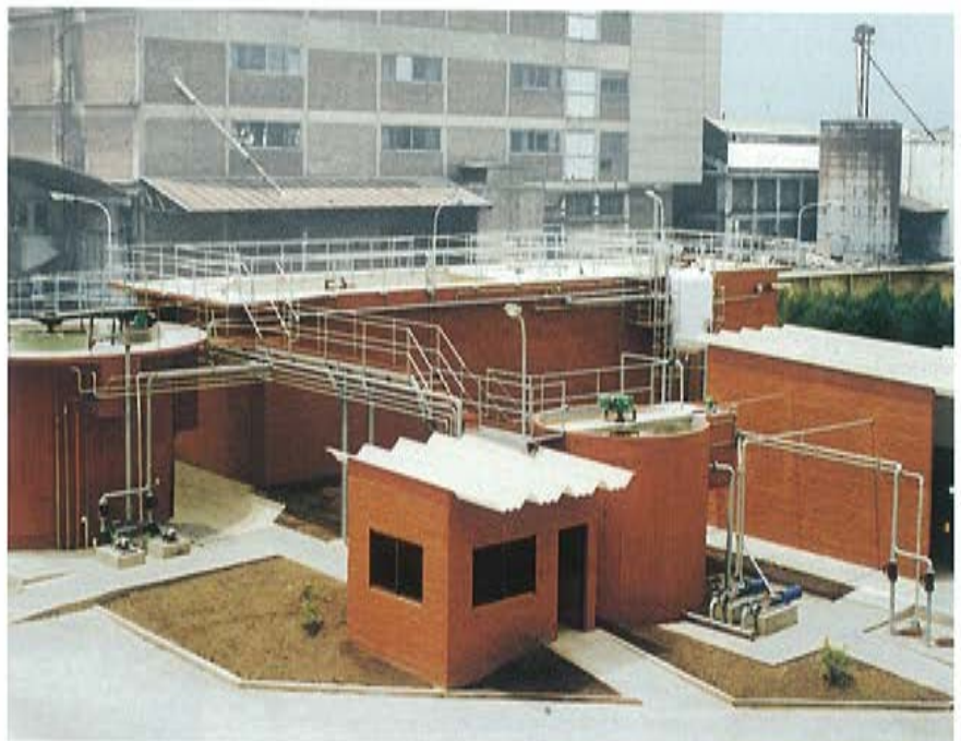
Die neue Kläranlage in Avellaneda reinigt täglich rund 150 Kubikmeter Abwasser.
