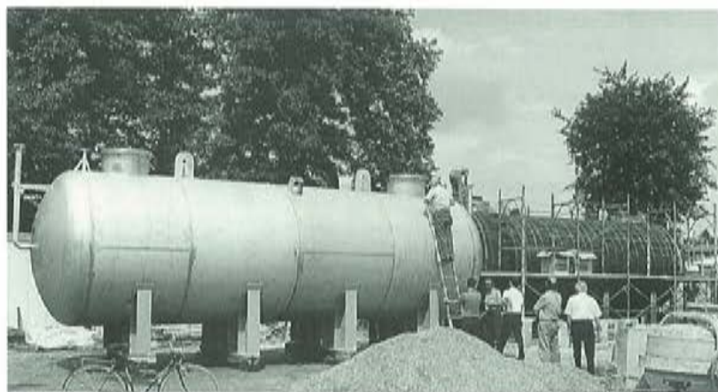
Die drei Lagerbehälter erhielten eine dicke Feuerschutz-Isolierung.
