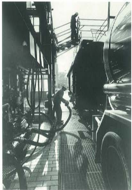
Beim Entladen von Tankwagen sorgt eine Auffangwanne dafür, daß bei unvorhergesehenen Leckagen keine Chemikalien ins Erdreich gelangen können.
