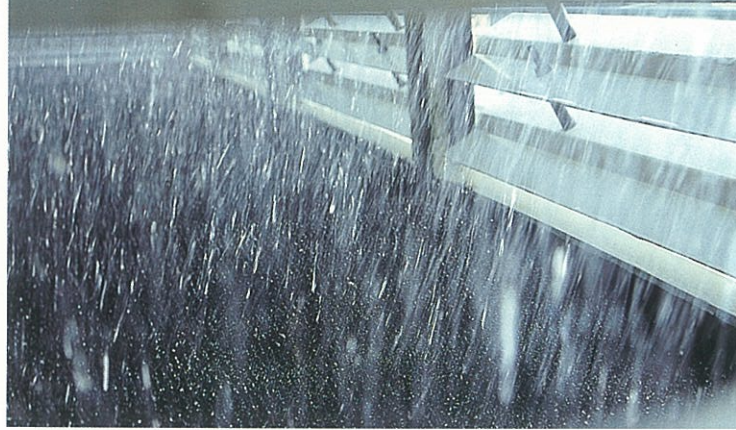
Schallschutz in Düsseldorf: „Tropfenprallabschwächer“ in einem Kühlturm vermindern das Wasserrauschen.
