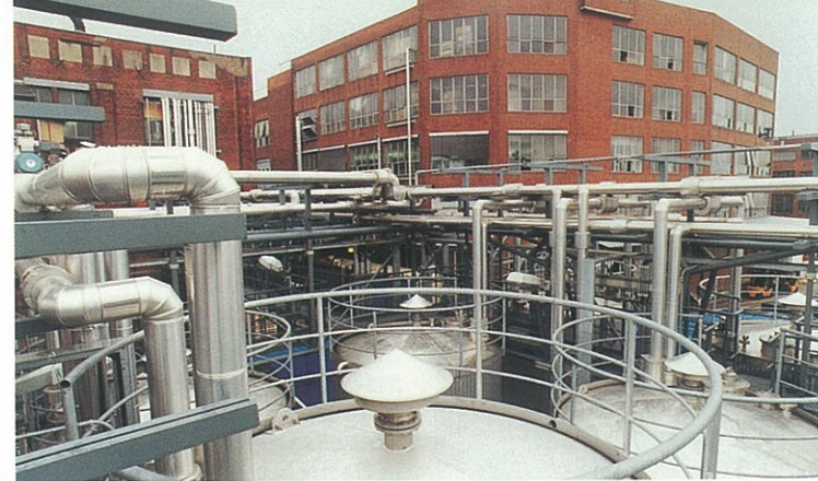
Umweltschutz wird auch bei Thompson-Siegel in Düsseldorf großgeschrieben: im Vordergrund das Tanklager.
