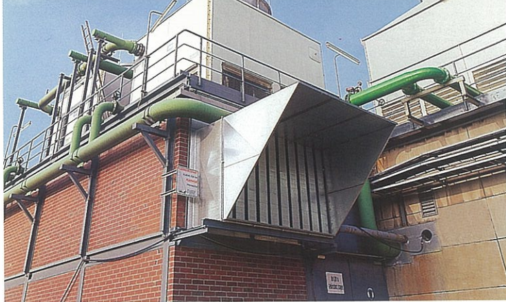
Weniger Lärm-Emissionen einer Sulfieranlage in Düsseldorf: durch Schalldämpfer an den Lüftungsgittern eines Raums, in dem große Kompressoren lautstark arbeiten.
