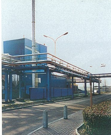
Verringerung der Emissionen: Im Kraftwerk der Henkel Polska in Racibórz (Ratibor) wurde schrittweise Kohle durch Gas ersetzt.
