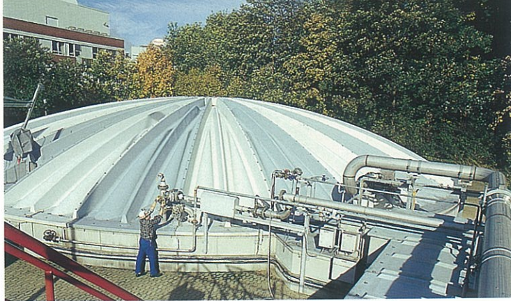
Henkel in Düsseldorf-Holthausen hat die Abwasser-Menge und -Belastung mit AOX deutlich reduziert: hier die Zentrale Abwassersicherungsanlage.
