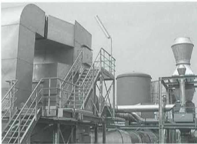
Reine Luft im Düsseldorfener Klebstoffwerk Nord: Lösemittelhaltige Abluft wird im Thermo-Reaktor verbrannt.
